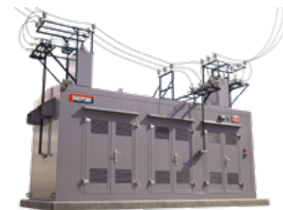
Пункты автоматического регулирования напряжения
